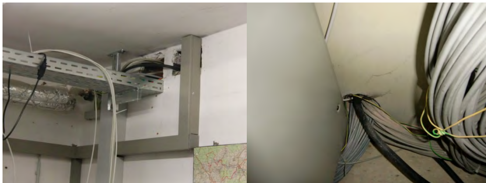
Die Bilder zeigen Beispiele fehlender Brandabschottungen bei Leitungsdurchführungen.
