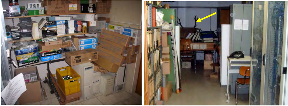
DV-Material und Aktenordner in Serverräumen. Auf dem rechten Bild ist im Hintergrund (Pfeil) ein Hirschgeweih erkennbar.
