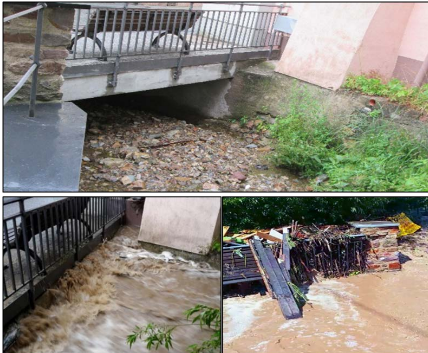
Überschwemmung im Juni 2016 in Stromberg. Das obere Foto zeigt die Gewässersituation mit Durchlass vor dem Starkregenereignis; die Fotos unten zeigen die Situation während (links) und nach (rechts) dem Starkregenereignis; Quelle: Gemeinde.
