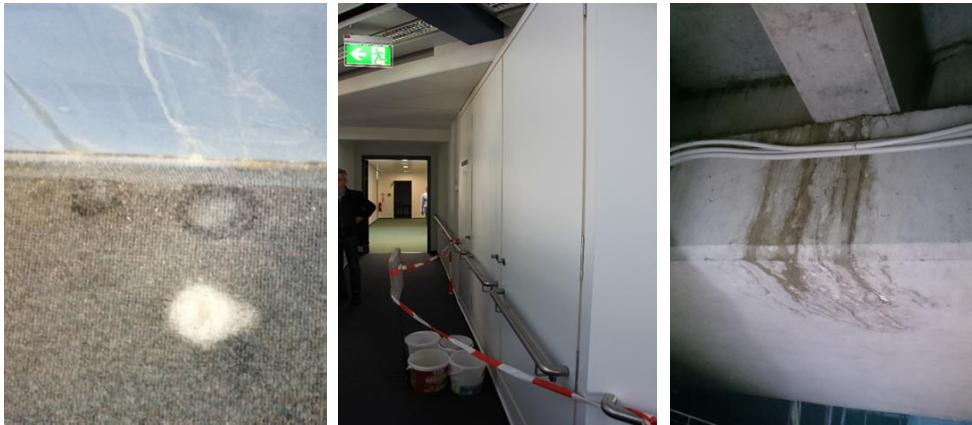
Wasserschäden in den Gebäuden A/B und BZ. Quelle: Rechnungshof Rheinland-Pfalz.
