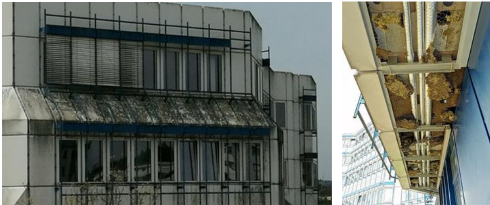
Fassadenverschmutzungen und Schadnagerbefall an den Gebäuden A und D. Quelle: Rechnungshof Rheinland-Pfalz.
