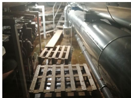
Überschwemmung im zentralen Versorgungstunnel nach Rohrbruch. Quelle: Rechnungshof Rheinland-Pfalz.
