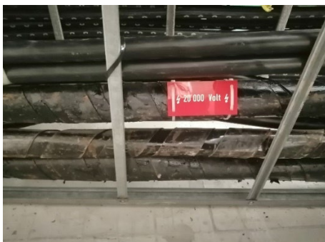
Starkstromleitungen mit brüchigen Bitumenummantelungen. Quelle: Rechnungshof Rheinland-Pfalz.
