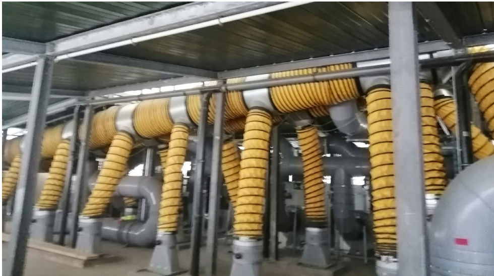
Provisorische Lüftungsleitungen im Fachbereich Chemie. Quelle: Rechnungshof Rheinland-Pfalz.
