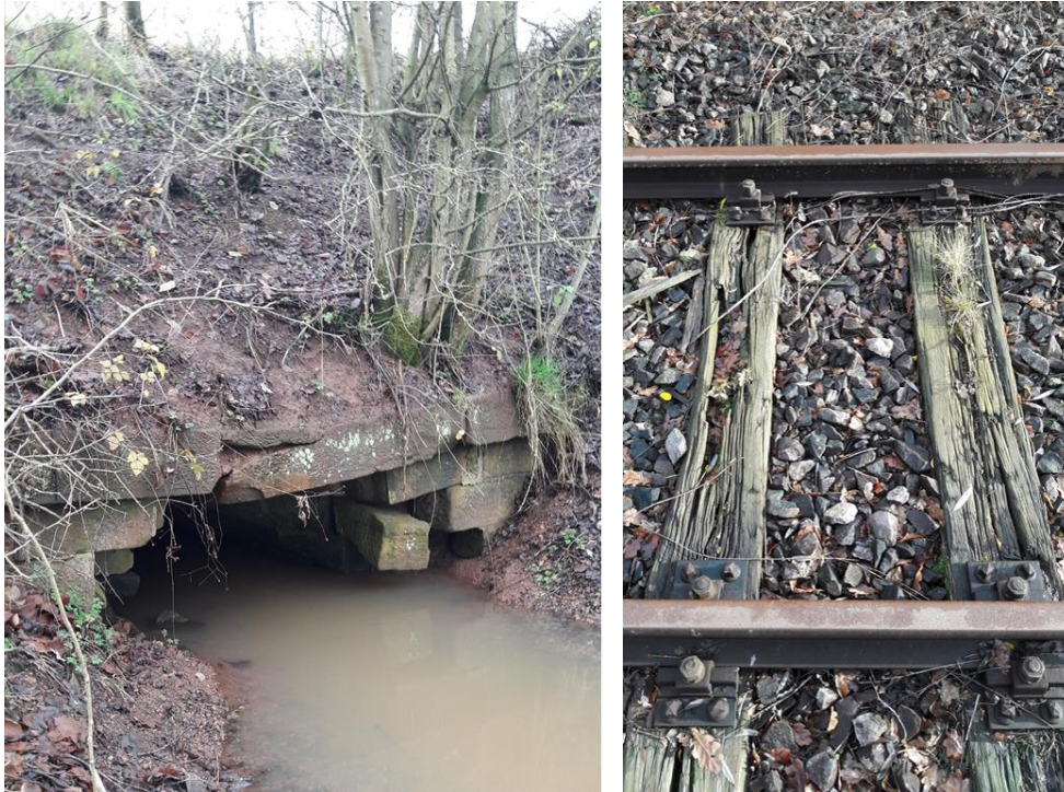
Die beiden Fotografien zeigen Schadensbilder, die an mehreren Stellen festzustellen waren. So war beispielsweise die über einen Bach führende Tragkonstruktion des Ingenieurbauwerks unter dem Bahndamm eingebrochen.
