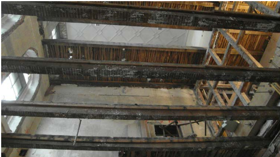
Zustand des teilweise entkernten Gebäudes im Februar 2017; Blick vom Erdgeschoss auf die abgehängte Decke über dem zweiten Obergeschoss und auf die nicht tragfähigen Holzbalken der Geschossdecken sowie die Holzkonstruktion der Fachwerkwände.
