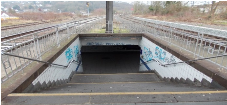
Die Fotografien zeigen den in erheblichem Umfang sanierungs- und modernisierungsbedürftigen Bahnhof Diez. Ein konkreter Realisierungshorizont für planerische Überlegungen zur Herstellung der Barrierefreiheit wurde dem Rechnungshof nicht genannt.
