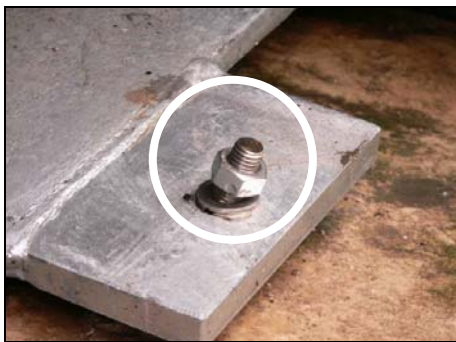
Landesstraße 538 (Westheim - Bellheim) lose Verschraubung
