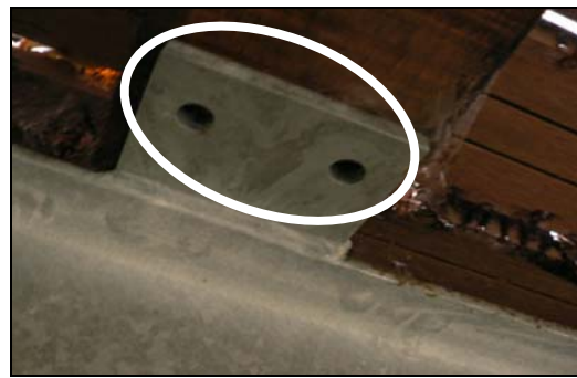
Landesstraße 542 bei Kandel: fehlende Schrauben
