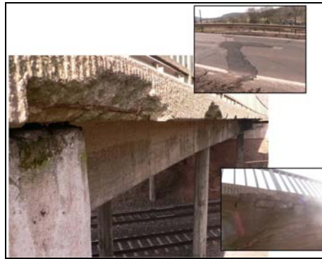
L 141 - Brücke über DB-Strecke bei Dörsch-Salmtal Zustandsnote 3
