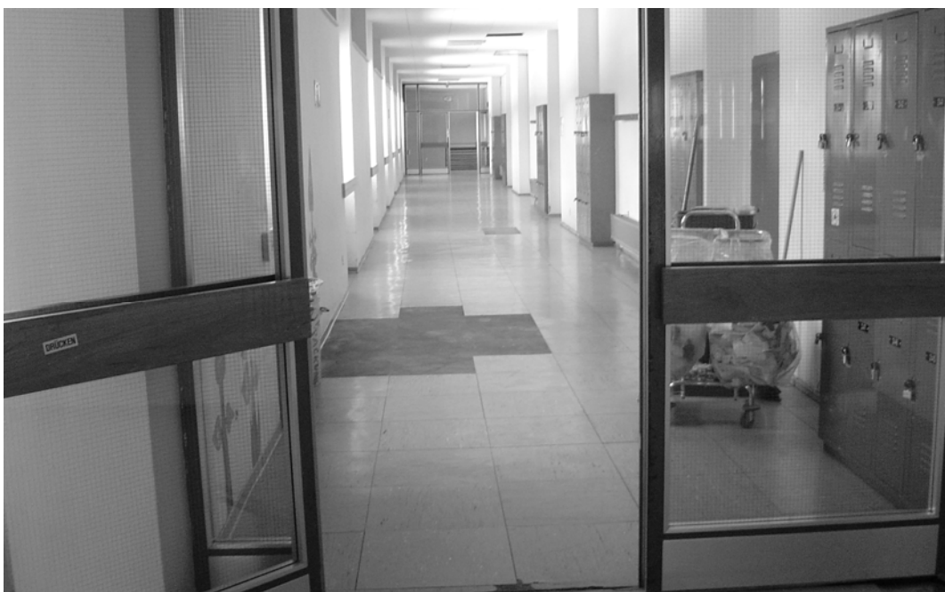
Beispiel 2: Fehlender und schadhafter Bodenbelag
