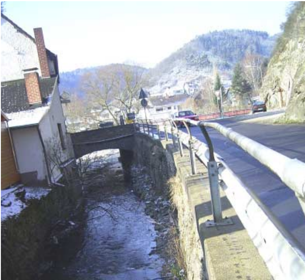
Schadhafte Stützwand und Brücke des Kesselinger Bachs
