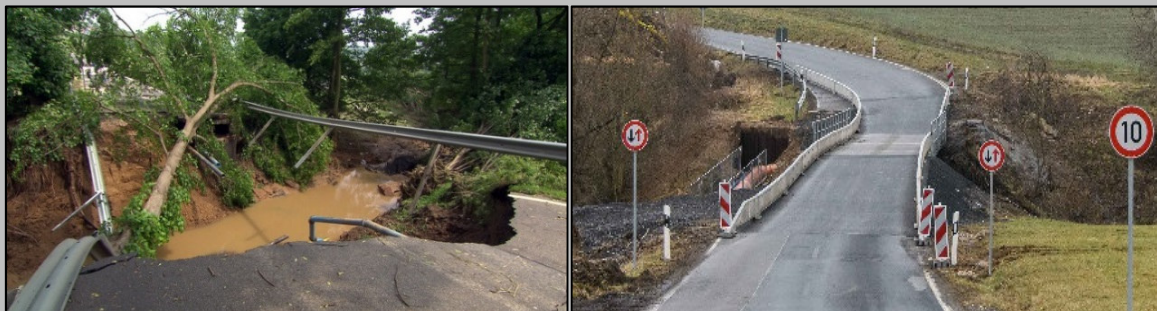
Abb. 24 L 79 zwischen Leimersdorf und Birresdorf: Unterspülung der Fahrbahn im Brückenbereich im Juni 2016 (links); provisorische Verkehrsführung und Behelfsbrücke ab Dezember 2016 (rechts) 129
