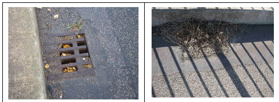
Abbildung 33: Verstopfte Straßenabläufe auf Brücken
