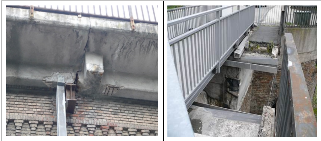
Abbildung 24: Schäden an der Pfaffendorfer Brücke, Koblenz
