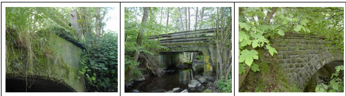
Abbildung 31: Dichter Grünbewuchs an Brücken
