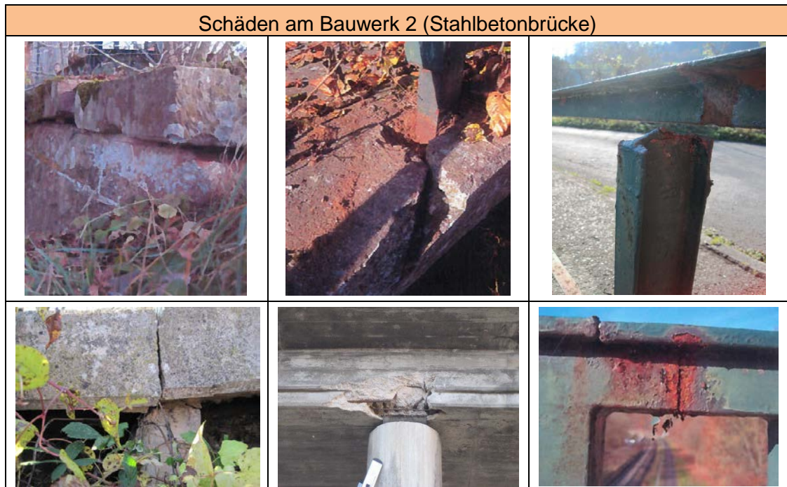
Abbildung 39: Ausgewählte Schäden und Mängel am Bauwerk 2
