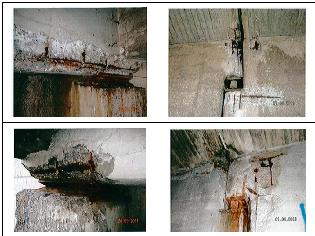
Abbildung 16: Schäden am Überbau
