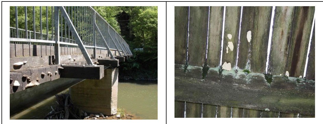
Abbildung 35: Pilzbefall durch mangelhaften Holzschutz
