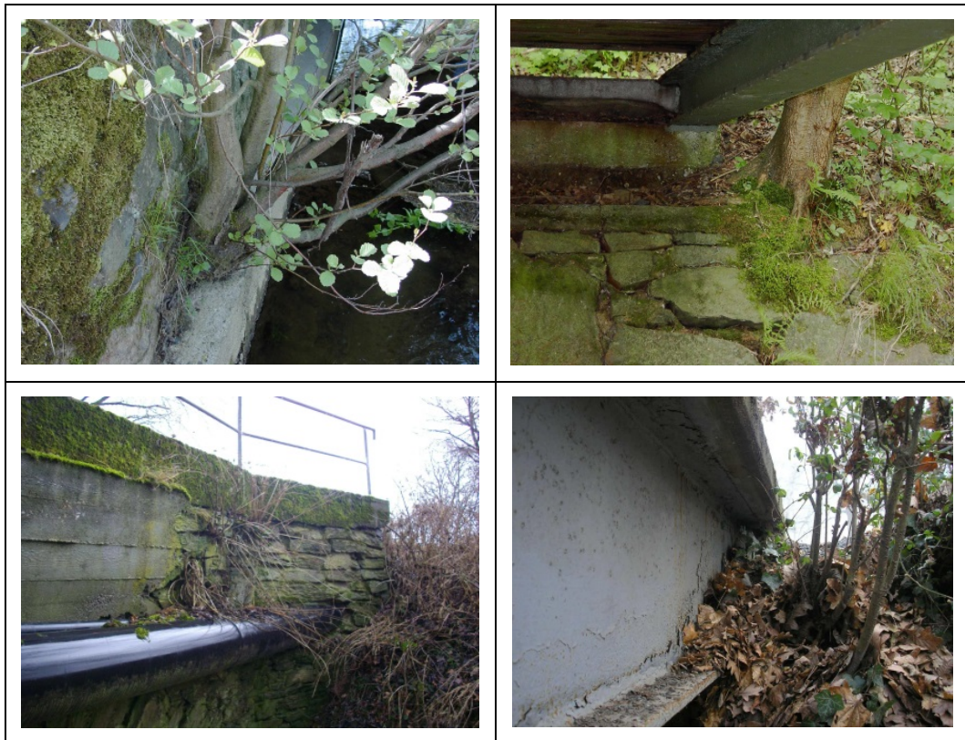
Abbildung 32: Schäden durch Bewuchs
