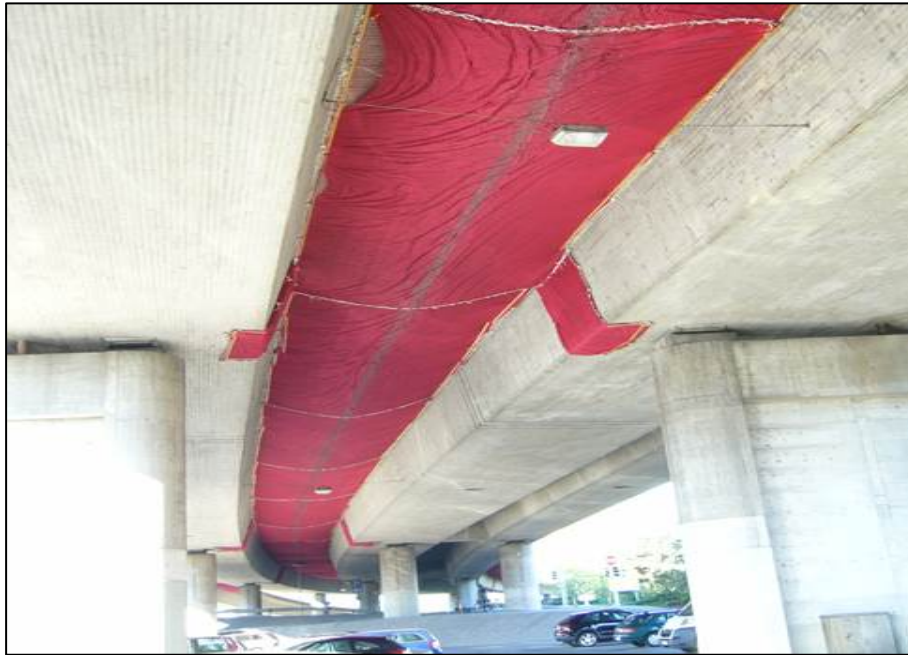
Abbildung 25: Fangnetze unter der Hochstraße Nord, Ludwigshafen
