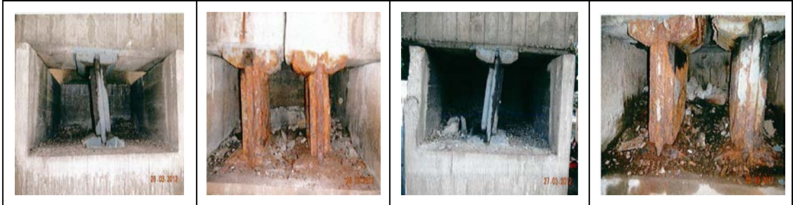
Abbildung 17: Schäden an den Lagern
