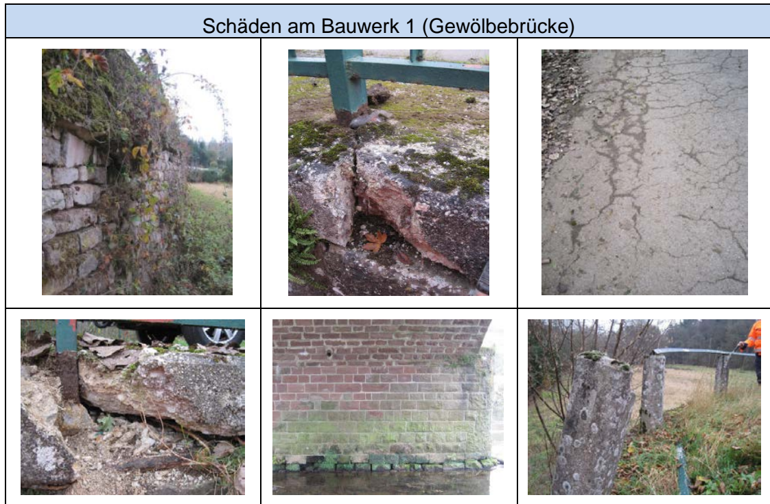
Abbildung 38: Ausgewählte Schäden und Mängel am Bauwerk 1
